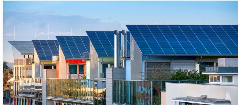
Photovoltaik (Quelle: wohnen.pege.org)
